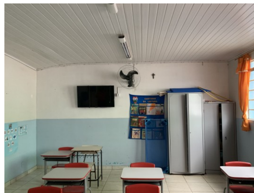
Foto 10: Forro da Sala 02 danificado
