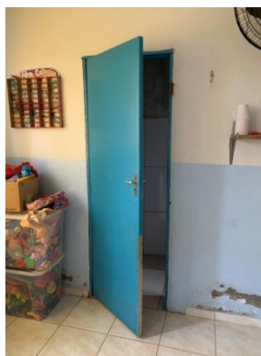
Foto 06: Atual porta do banheiro do Maternal
